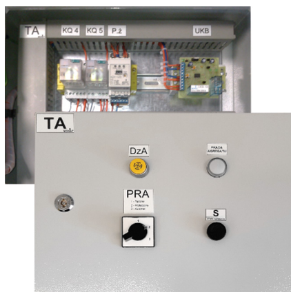
Widok Tablicy TA wewnętrznej
