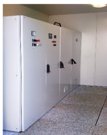
Widok kontenerów z zabudowanymi urządzeniami zasilającym
