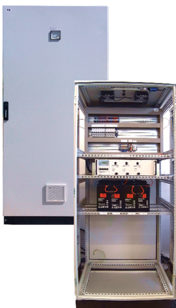
Widok szafy redundanтной TB
